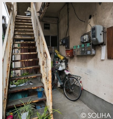
Escalier extérieur et installation électrique à reprendre.
